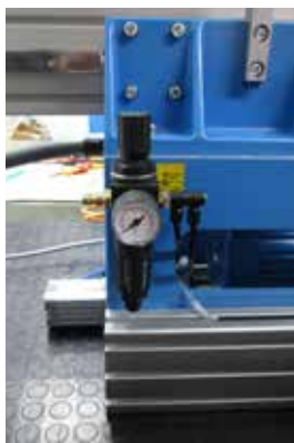
Rys.: Jednostka konserwacyjna instalacji pneumatycznej (z perspektywy operatora, z tyłu po lewej stronie stelażu maszyny)
